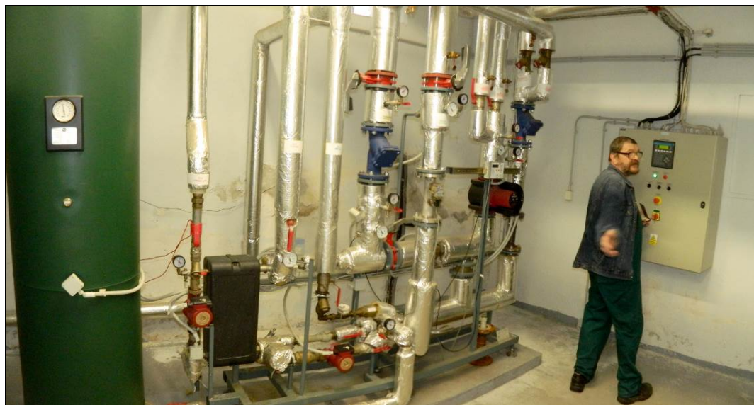
Typická předávací stanice
